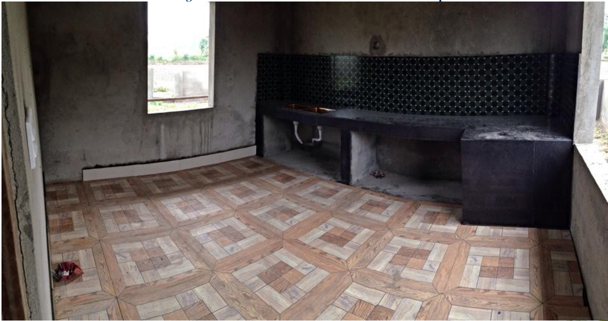
Aménagement intérieur de la cuisine. Photo Pemba Sherpa©
